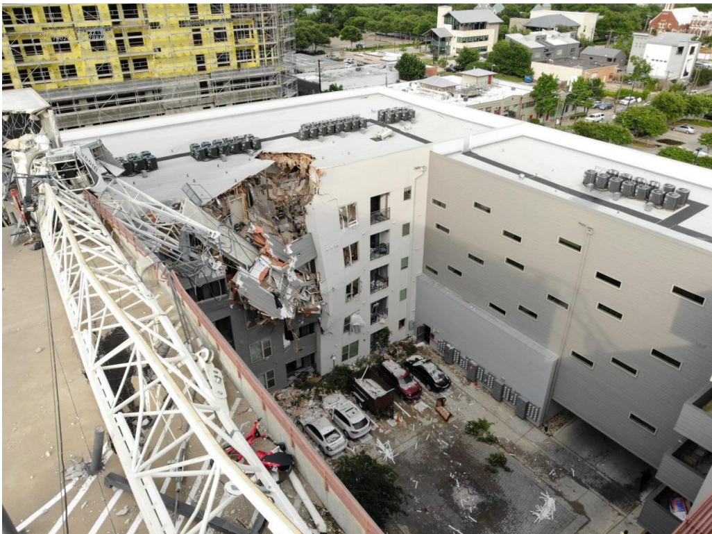
Foto cortesía del equipo North Texas PSURT, colisión de dos grúas.
